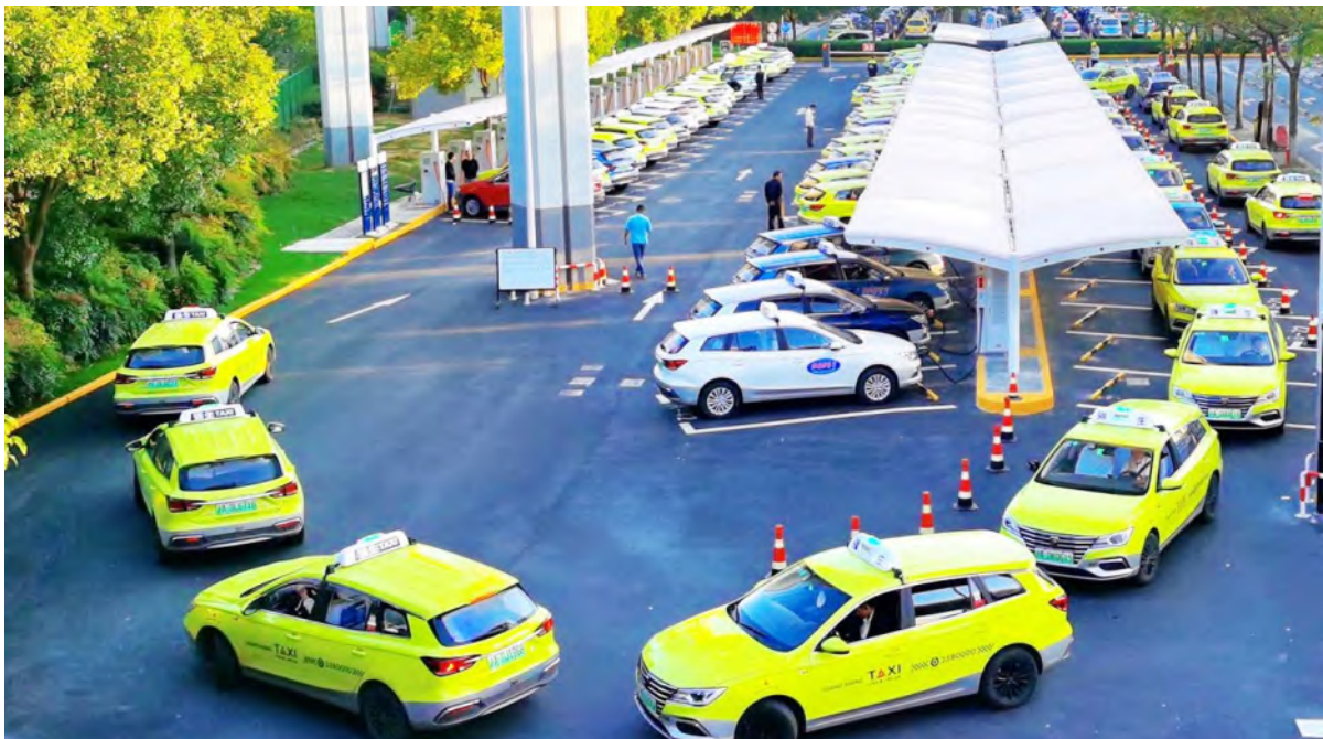
中国上海虹桥机场出租车充电场站
