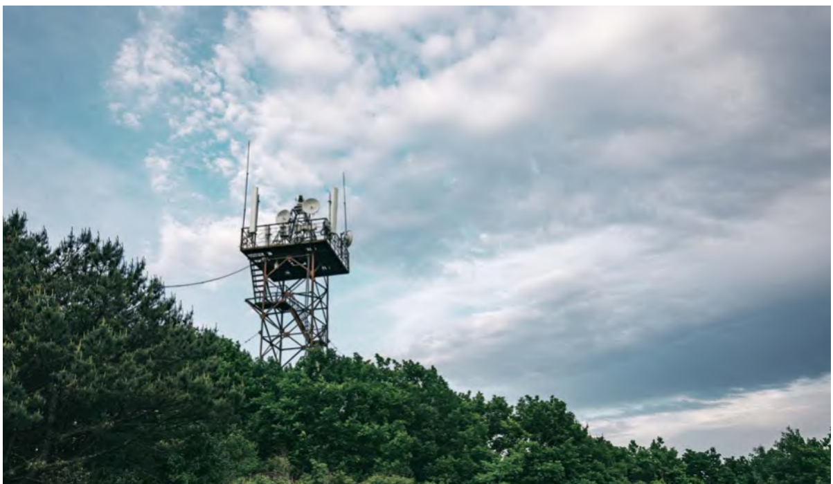
东北虎豹国家公园 LTE 基站，利用原有的防火塔，减少对自然的影响
