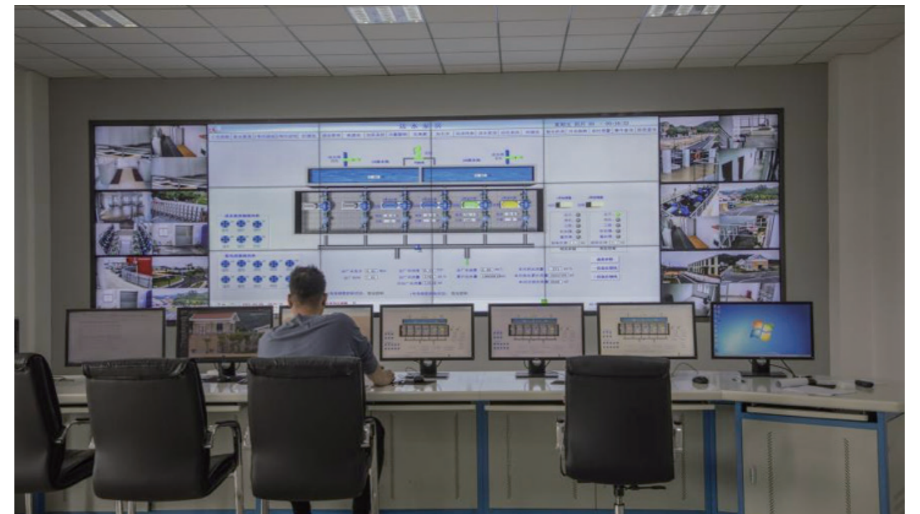
(金鸡水厂中控室现场图)
